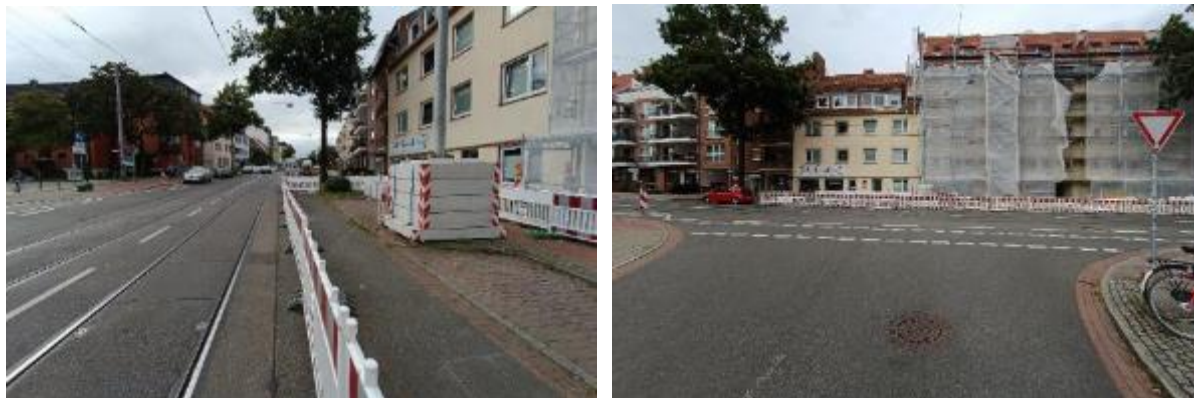
Abbildung 88: Links "Querungshilfe" für Radfahrende gegenüber des Luise-Koch-Platzes (hier unter Betongewichten verborgen). Die Parkbuchten reichen links und rechts direkt an den auf die Straße mündenden Radweg heran, zusätzlich wird in zweiter Reihe geparkt (s. Abbildung 87). Die Querungshilfe ist dadurch praktisch nur aus der gegenüberliegenden Richtung nutzbar (rechts, durch Baustellenzaun versteckt; Fotos: ecolo).
